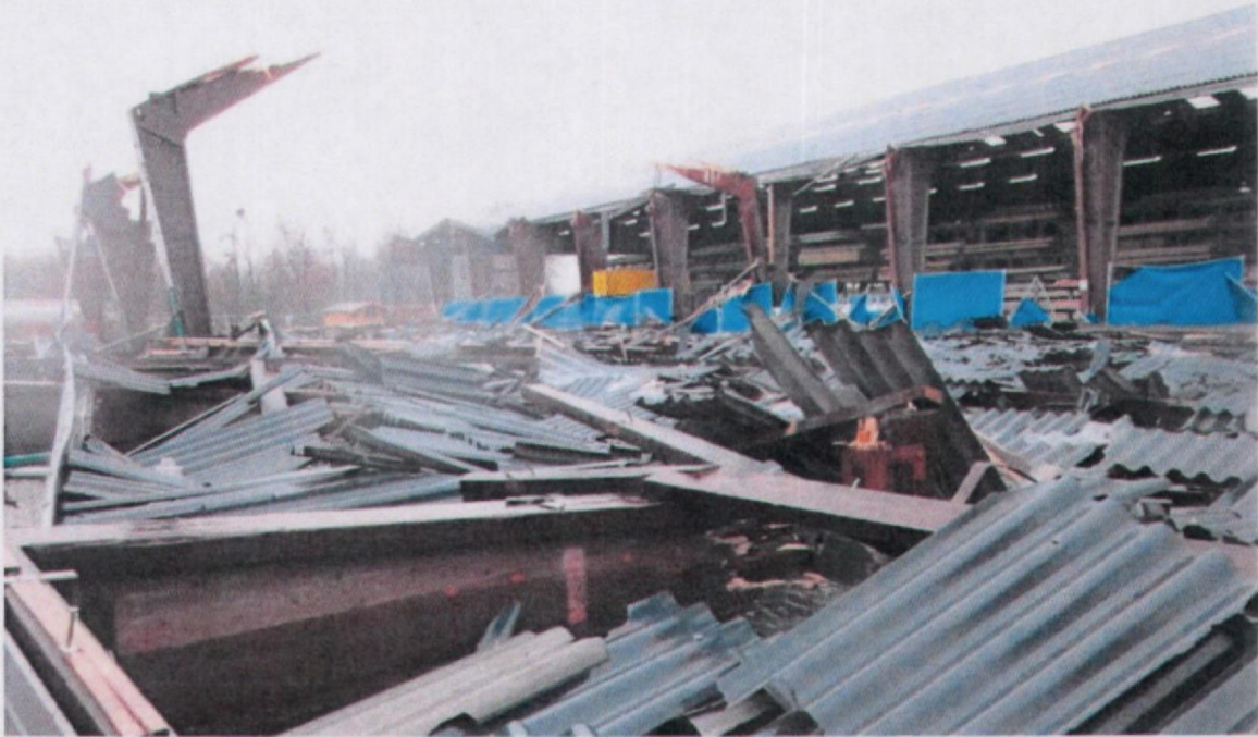
Foto: Na een hevige sneeuwbuï bleek deze constructie niet sterk genoeg om het gewicht van de sneeuw te kunnen dragen.
